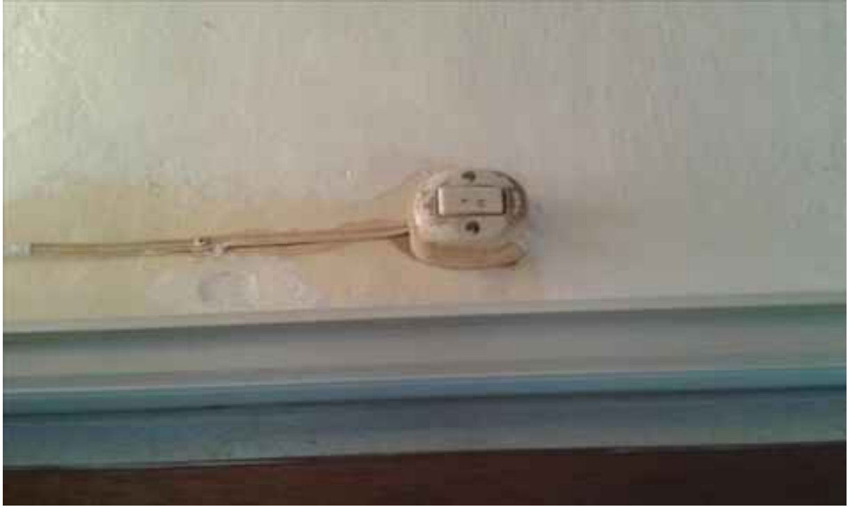
PARTCOLARE IMPIANTO ELETTRICO
